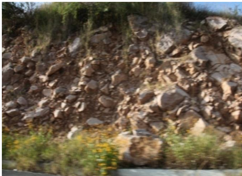
Figura 110. Andesitas de color gris claro que sobreyacen a las tobas, se encuentran fuertemente fracturadas e intemperizadas. Fuente: Luis Valdivia Ornelas
