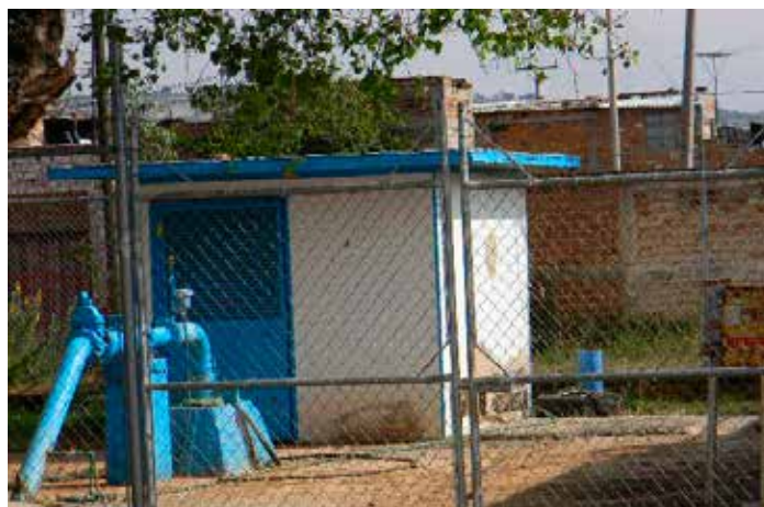
Pozo de agua ubicado en la Av. Ramón Corona
