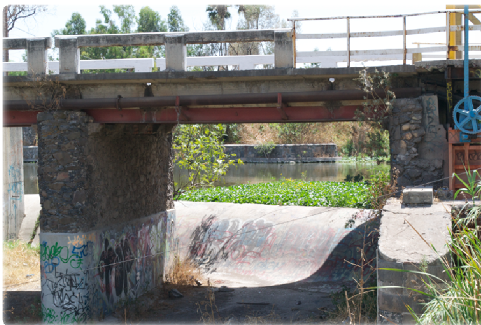
Imagen 9. Cortina de la antigua planta hidroeléctrica obstruyendo el paso del agua
