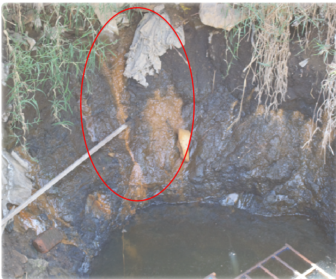
Imagen 7. Pozo de agua de los ladrilleros localizado a pocos metros del canal con infiltraciones de contaminantes.
