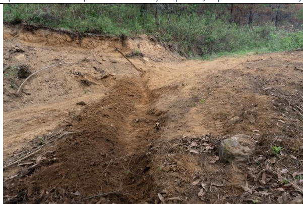
Actividades de la Brigada Regional de Manejo del Fuego Regional (Rehabilitación de caminos de acceso a zonas de alto riesgo de incendios, en el Ejido Chiquihuitlan Mpio. de Autlán)
